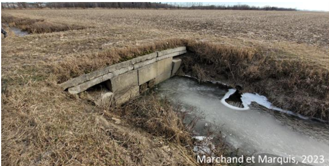
Figure 2 : Ponceau artisanal en milieu agricole où la connectivité hydrosédimentaire est altérée et qui ne permet pas le libre passage du poisson (source et crédit photo: Marchand et Marquis 2023).
