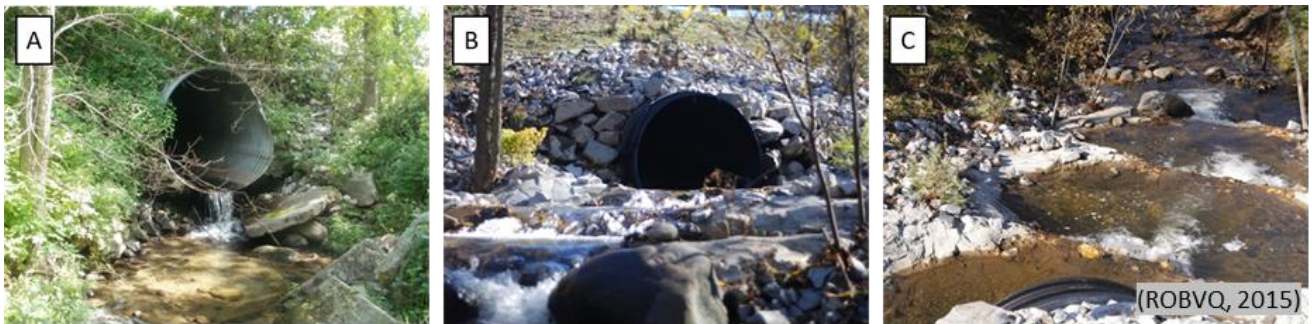
Figure 3 : Restauration du libre passage du poisson à la sortie d'un ponceau qui présentait une chute infranchissable avant les travaux (A) et après la restauration où l'on voit les bassins aménagés à la sortie du ponceau avec vue vers l'amont (B) et vers l'aval (C) (ROBVQ, 2015).
